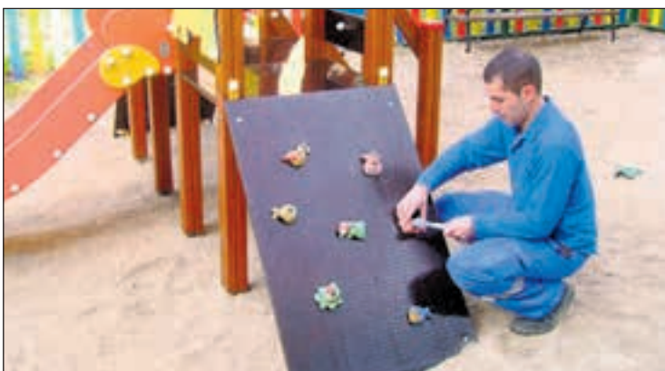
La adjudicataria se encargará de la reparación de todo tipo de desperfectos.
